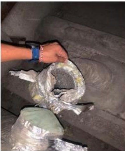
Peça: Duto Avaria: Peça em situação crítica (inapta)
