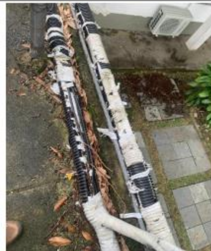
Peça: Tubulação Avaria: Sem isolamento
