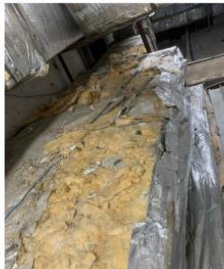
Peça: Manta de lã de vidro Avaria: Sem isolamento e corroído.
