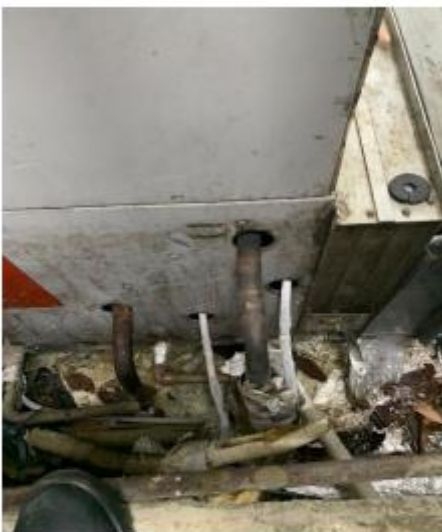
Peça: Tubulação Avaria: Sem isolamento
