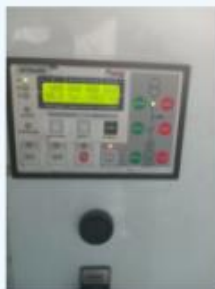
REGISTRAR A LIMPEZA INTERNA DO QUADRO DE CONTROLE DO
